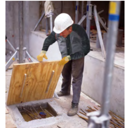
Mit wenigen Handgriffen können Stolperfallen richtig abgesichert werden. (Foto: BG Bau)
