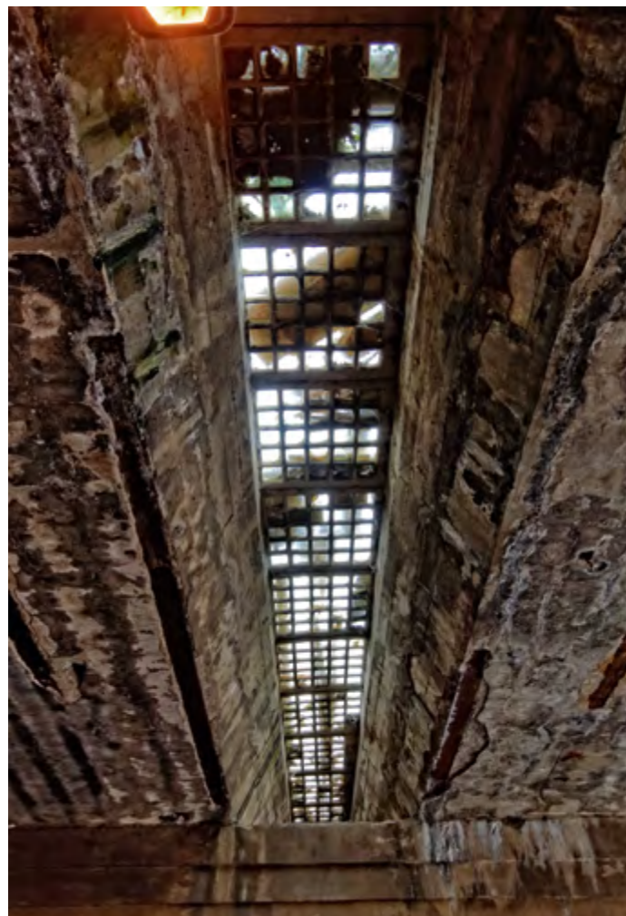
Die Unterführung Olzmannstraße im Zwickau ist schwer in die Jahre gekommen. Durch den Abriss einiger Brücken kommt dann auch wieder mehr Tageslicht in den Tunnel.
